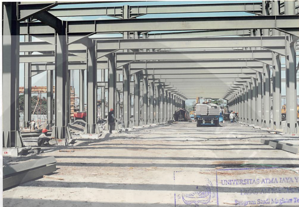
Lampiran foto 4.17. Balok dan kolom baja king cross
