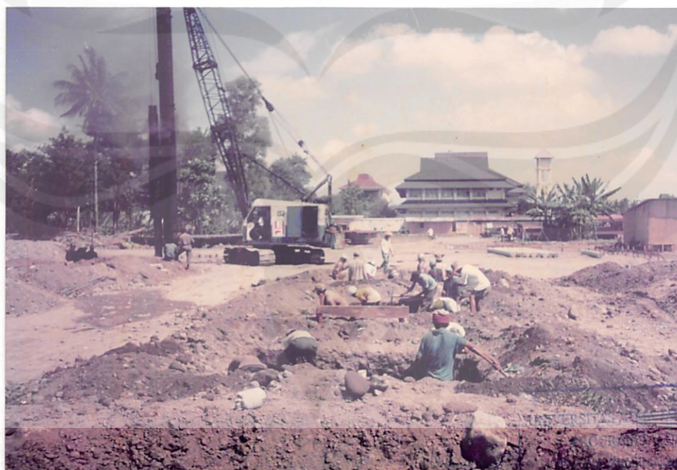
Lampiran foto 4.6. Overlapping pekerjaan pemancangan dengan pile cap
