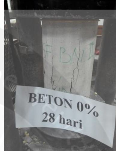
Retakan Beton Normal
