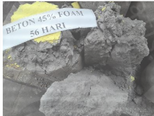
Retakan pada SF45%
